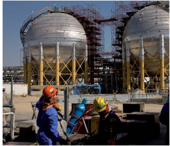
Sphères de stockage du projet OL2K (Koweït)
